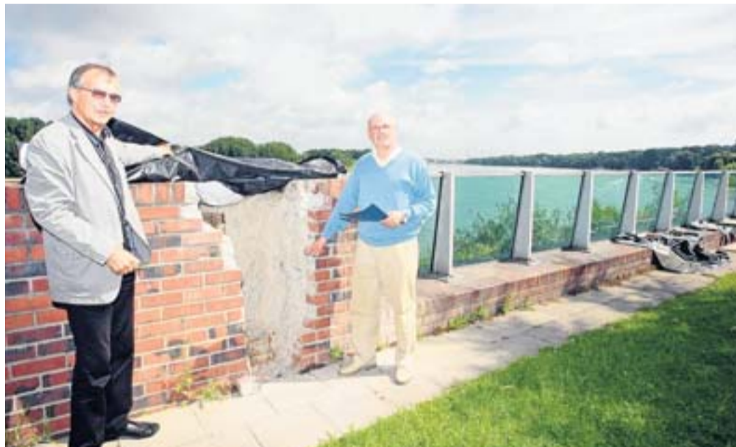
Deichgräf Artur Auweiler (r.) und Eduard Breimann zeigen die Schäden an der Mauer. Foto: Archiv
